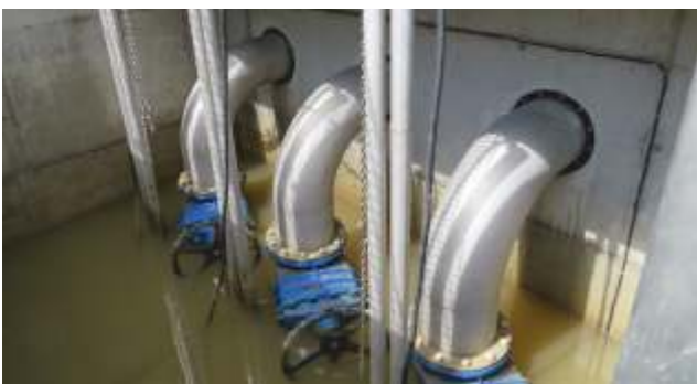
▲ Unterirdisches Schöpfwerk mit drei Pumpen
