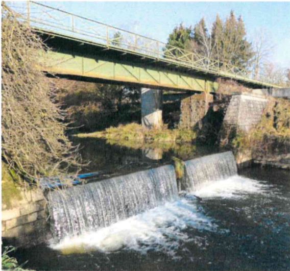
Abb. 1: Absturz am Kinsach-Mehnach-Ableiter bei Fkm 0,500 unterhalb der Eisenbahnbrücke
